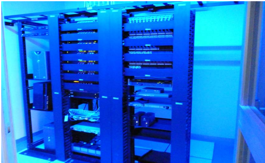
Figura 7. Cuarto de equipos. Copyright 2011. http://yesconnected.com/
