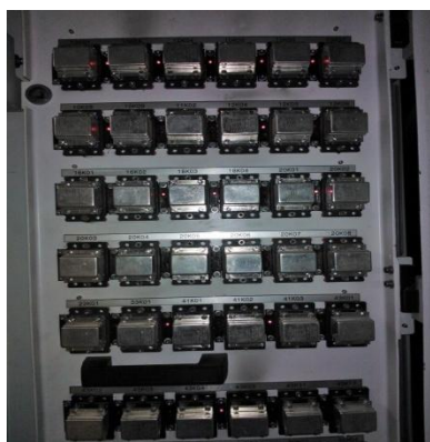
Foto 17. Relés Encapsulados, Manejan el control de diferentes equipos del tren, cuando estos fallan, se presentan altos porcentajes de evacuación o retraso de unidades en vía comercial.
