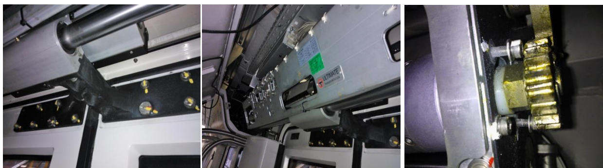
Foto 18-19-20 Sistema mecánico y eléctrico de puertas de pasajeros y motores de puertas, cuando hay fallos en estos sistemas, presenta un porcentaje mayor de evacuación y retrasos en línea.
