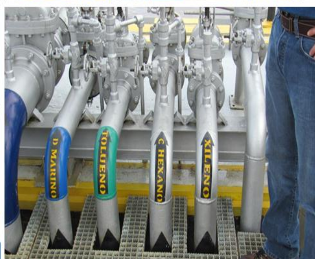
Líneas de Cargue Xilol y Toluol. Rata de bombeo 800 barriles/hora → 10mil barriles en 13 horas
