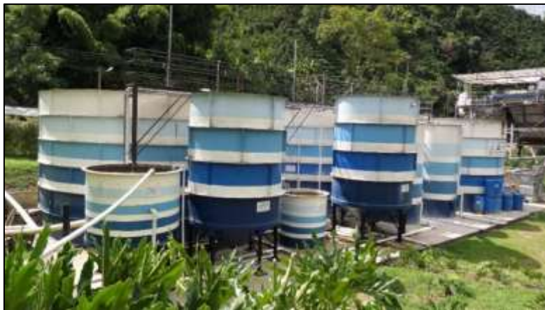
Ilustración 20- Planta de tratamiento de aguas residuales - Fuente propia
