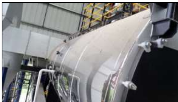
Ilustración 18 - Caldera LA CENTRAL – Fuente propia
