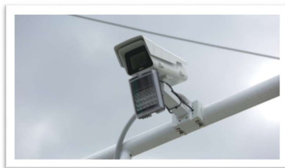
Figura 15. Cámaras y elementos complementarios
