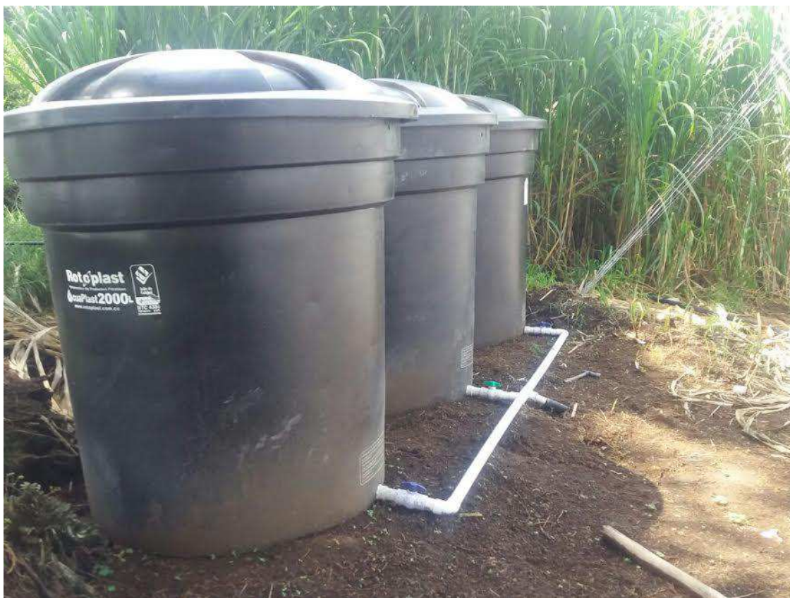
Figura 5.8 - Tanques de almacenamiento de agua
